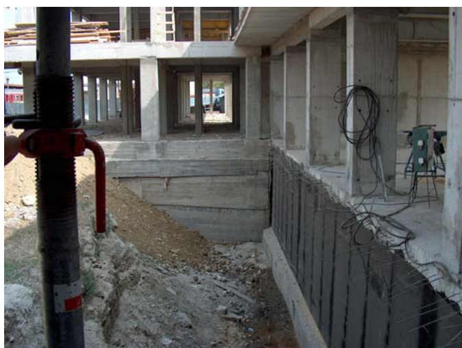
Foto 5 Rost continuat și la nivelul infrastructurilor
