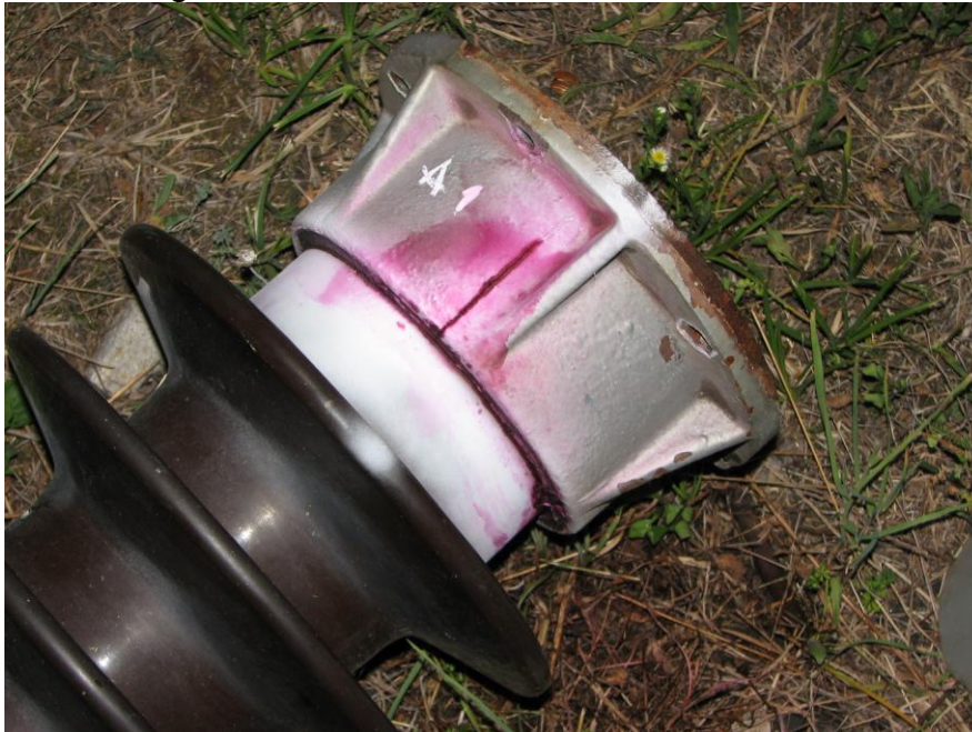
Fig.2.4. Longitudinal fissure in the metallic cup.
